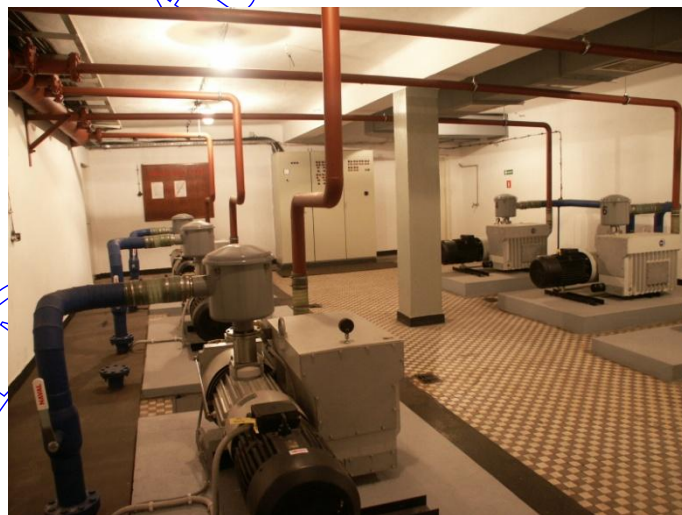
Rys. 4. Maszynownia próżni centralnej wykonana na bazie pomp próżniowych jednostopniowych TEPRO AT-400B
