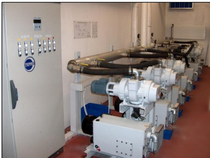
Rys. 3. System próżni centralnej produkcji TEPRO SA – przykładowa realizacja Fig. 3. Central vacuum system manufactured by TEPRO SA – exemplary implementation
